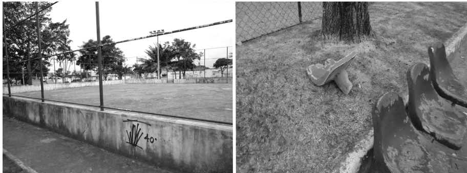
Figura 6: A la derecha (6.1), vandalismo y descuido en la cancha polideportiva de la Praça dos Ipês ; a la izquierda (6.2), destrucción del mobiliario urbano en Praça dos Ipês
